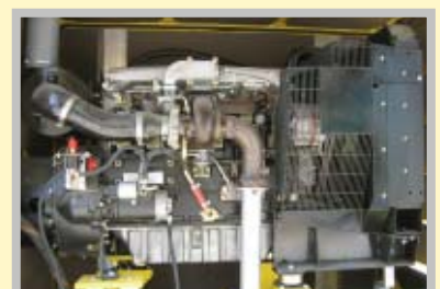
Moteur diesel réfrigéré
