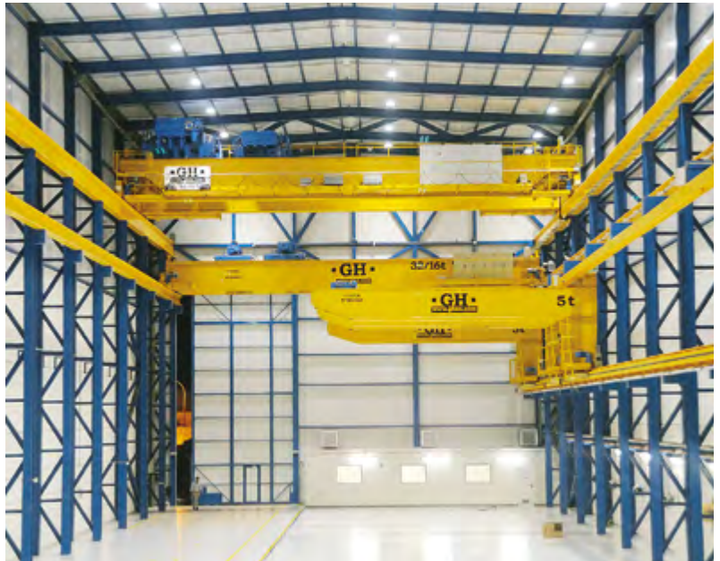
Grúa birrail y grúa ménsula
